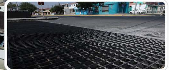
Pluvial Col. Las Puentes
