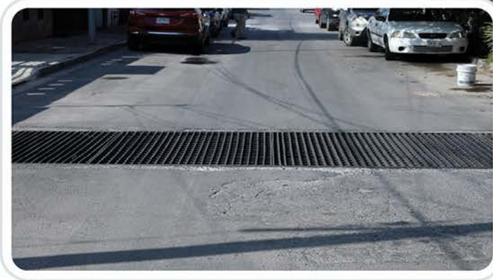
Pluvial Calle Enrique Salinas
